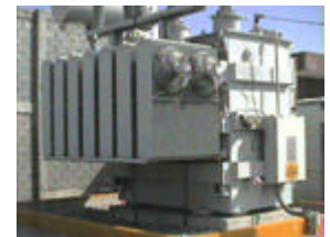
Transformador de potencia
